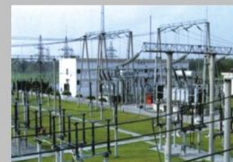
汉川贺富变电站
